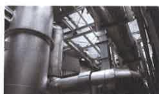
プラント配管
